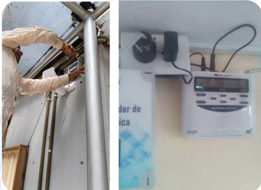
Ilustración 27. Instalación de alertas sísmicas en aulas bicentenario
