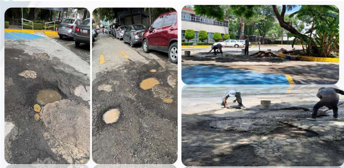
Ilustración 22. Bacheo del estacionamiento
